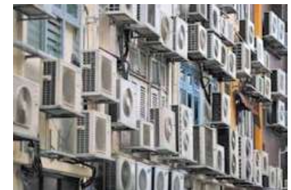
Figura 2. Aire acondicionado edificaciones Fuente: AARQHYS. (2017). Puedo Colocar mi Equipo en la Fachada. Recuperado el 06 11 2017. Sitio web. https://www.arqhys.com/contenidos/aire-acondicionado-edificios.html
