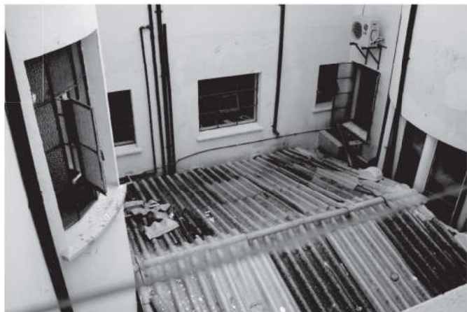
Foto 18. Teja que cubría el patio central . FOTO: A. Toro
