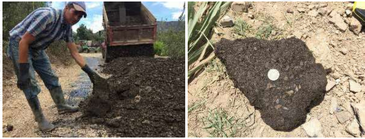
Figura 13. Irregularidades del material del fresado.
