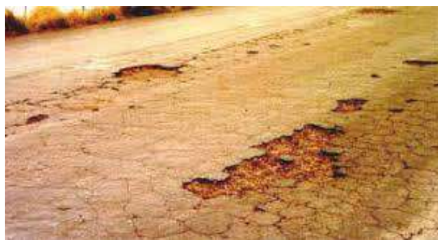
FIGURA 5. DESGASTE DE LA SUPERFICIE DE LA VÍA
