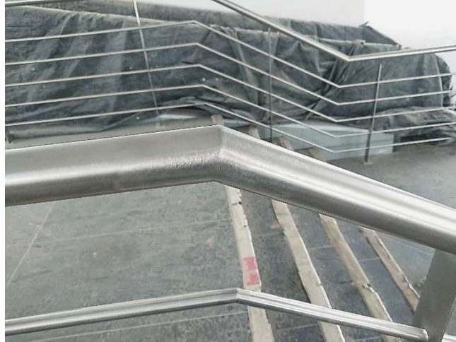
Figura 3. Ejemplo estructura acero inoxidable, barandas y pasamanos.
