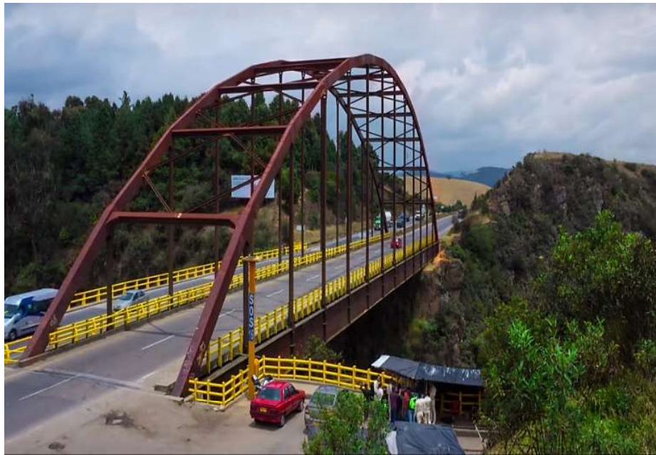
Figura 10. Ejemplo de estructura en acero autoprotector (Puente de la Represa del Sisga, Cundinamarca, Colombia) la capa color marrón que se aprecia en la estructura es la herrumbre formada por el proceso de oxidación del metal.
