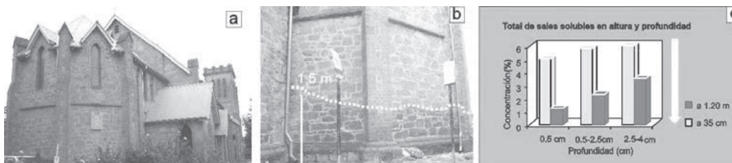
FIGURA 2. ASCENSO DE AGUA POR CAPILARIDAD. IGLESIAS ST. JOHNS, ADELAIDE, AUSTRALIA (A). MARCA SOBRE LA FACHADA (B). CONCENTRACIÓN DE SALES SOLUBLES ANALIZADAS POR CI EN ALTURA Y PROFUNDIDAD. FUENTE. RECUPERADO DE LÓPEZ, P. DAÑOS POR CRISTALIZACIÓN DE SALES. INSTITUTO DE GEO CIENCIAS (CSIC-UCM),2007.
