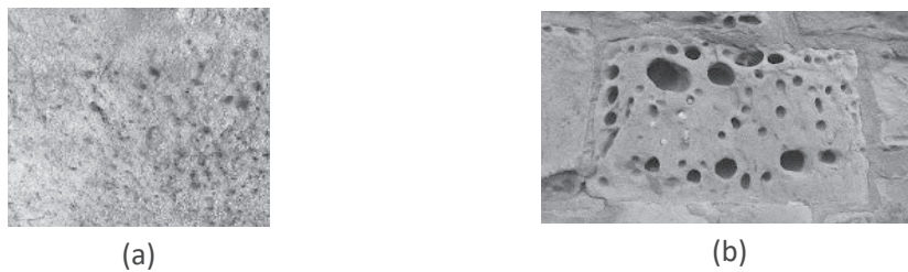
FIGURA 13. ( A ) ALVEOLIZACIÓN EN PAÑETE DE VIVIENDA DE LA CIUDAD DE TUNJA; ( B ) ALVEOLIZACIÓN EN SILLAR DE LA IGLESIA DE SANTA MARÍA Fuente. ( a ) Autores; ( b ) Recuperada de https://www.geocaching.com/geocache/GC6RM4T_iglesia-de-santa-maria?guid=e2fff2e6-6a29-4eb9-b32a-2d3b1f28c6b2
