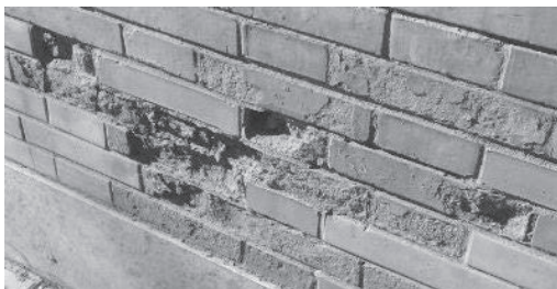
FIGURA 8. EFLORESCENCIAS DE SULFATO MAGNÉSICO. Fuente. Recuperado de https://obrasyreformasedefer.com/autor/admin/
