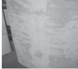
FIGURA 4 VELOS DE SECADERO. Fuente. Recuperado de Mejía, S. Origen de las Eflorescencias. 2013.
