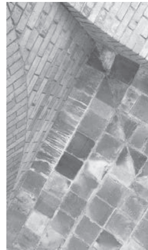
FIGURA 7. DEPÓSITOS DE CARBONATO DE CALCIO EN MUROS DE LA IGLESIA LAS NIEVES (TUNJA) Fuente. Autores
