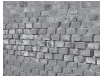
FIGURA 10. EFLORESCENCIAS DE VANADIO. Fuente. Recuperado de https://construcciontecnicasmc.wordpress.com/2015/05/23/eflorescencias/
