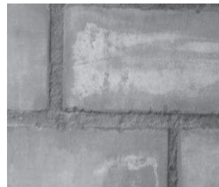
FIGURA 11. EFLORESCENCIAS DE SULFATO DE CALCIO (YESO) Nota. Recuperado de Mejía, S. Origen de las Eflorescencias. 2013.
