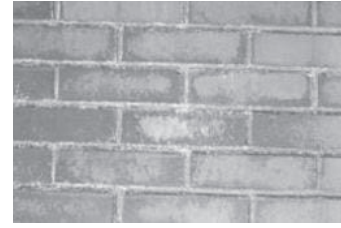
FIGURA 6. DEPÓSITOS DE SILICATOS. Fuente. Recuperado de Mejía, S. Origen de las Eflorescencias. 2013.
