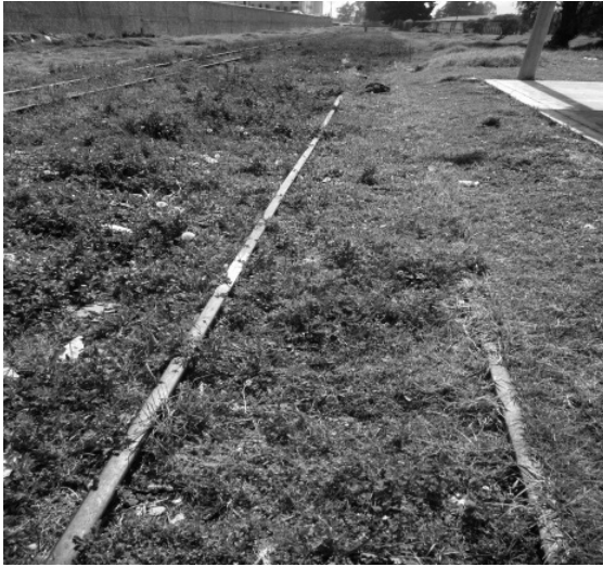
Figura 2. Rieles enmontados y traviesas podridas
