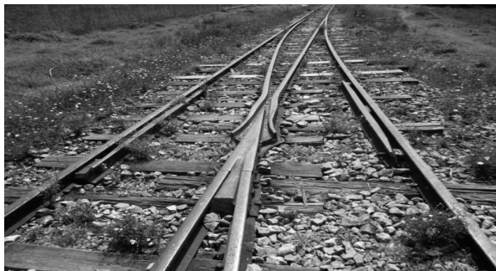
Figura 1. Abandono de la vía en intercambiador vial
