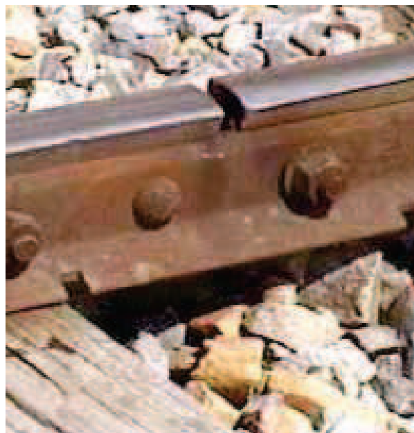
Figura 8. Dilatación de los Rieles
