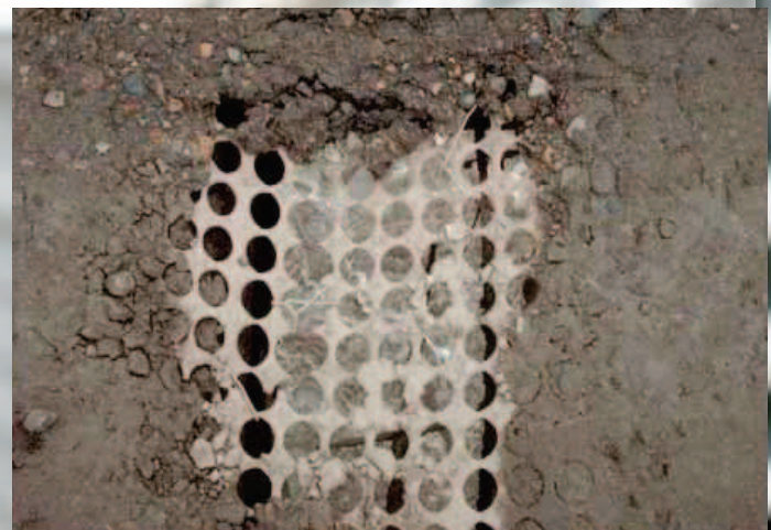
FIGURA 2. DETERIORO DE LA PLACA. Fuente: Autora del proyecto
