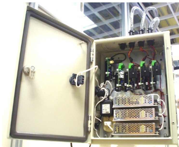
Figura 5. Gabinete que aloja al controlador.
