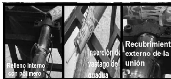
Fig.3: Relleno con polímero fundido, Inserto de vástago en junta, Armado y alineado de la junta
